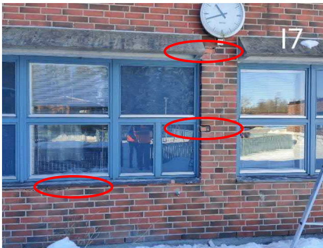
Kuva 59. Rakenneavaukset 17. Pystykarmin ja apukarmin välissä ei ollut tilkettä / uretaanivaahdotusta.
