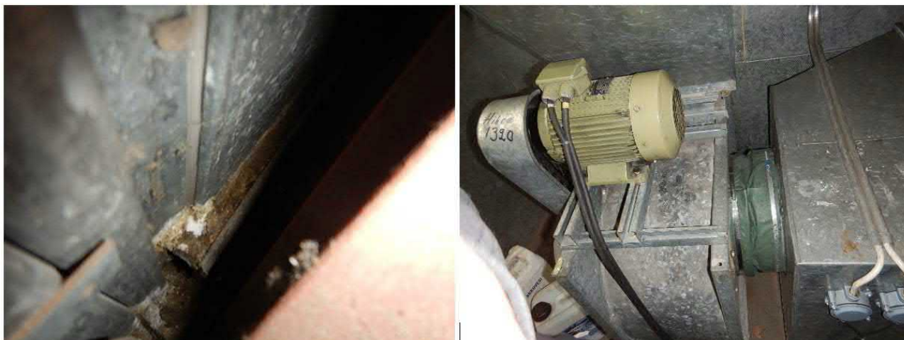
Kuva 116 Keittiön IV-koneen tarkastusluukkujen ulkopinnoilla likaa ja ruostetta. Poistoilmapuhaltimen asbestiliitin ilmeisesti vaihdettu.
