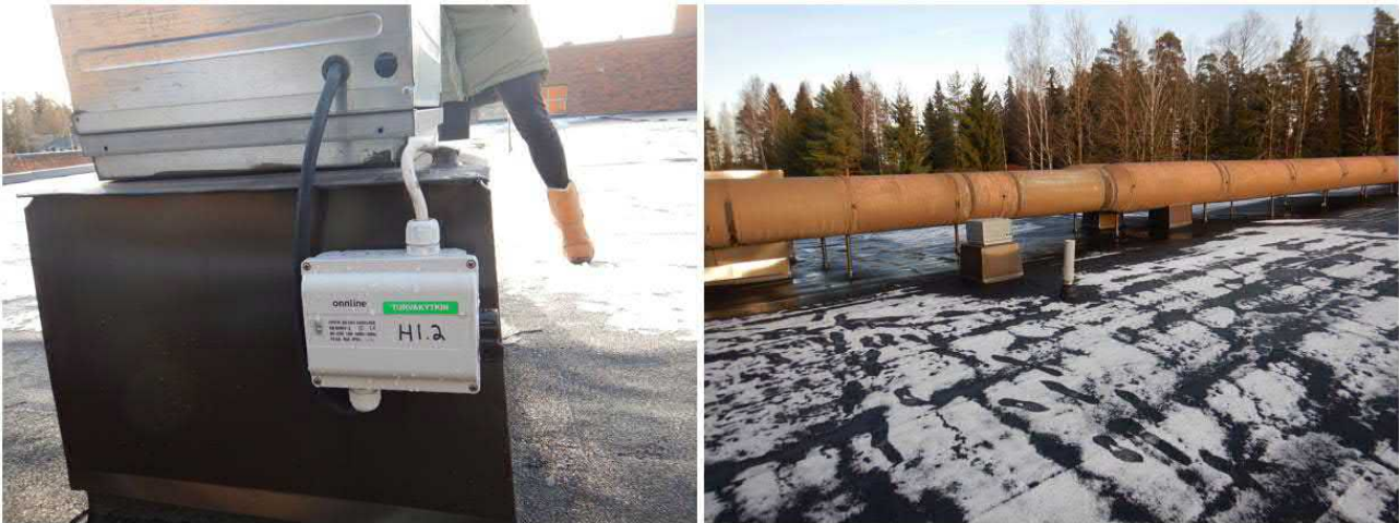
Kuva 125 Opetustilojen WC-tiloja palveleva HI.2:n kytkin oli off-asennossa. Katolla kulkevien kanavien eristykset todettiin silmämääräisesti ehjiksi.
