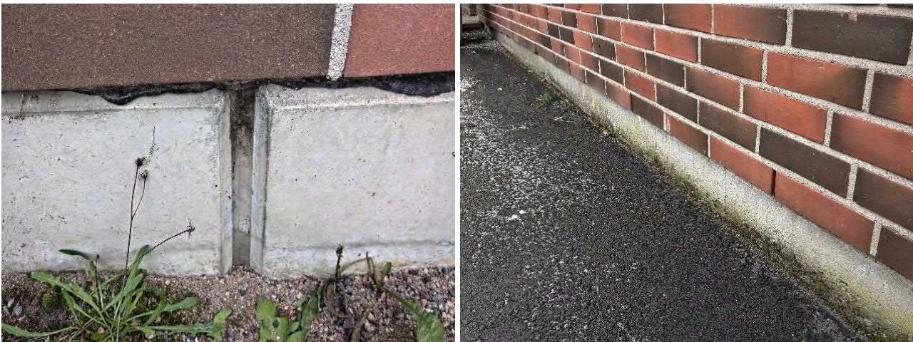
Kuva 22. Laajennusosan sokkelit (vasen kuva) on tehty elementtirakenteisina. Vanhan osan sokkeleista (oikea kuva) havaittiin leväkasvustoa.
