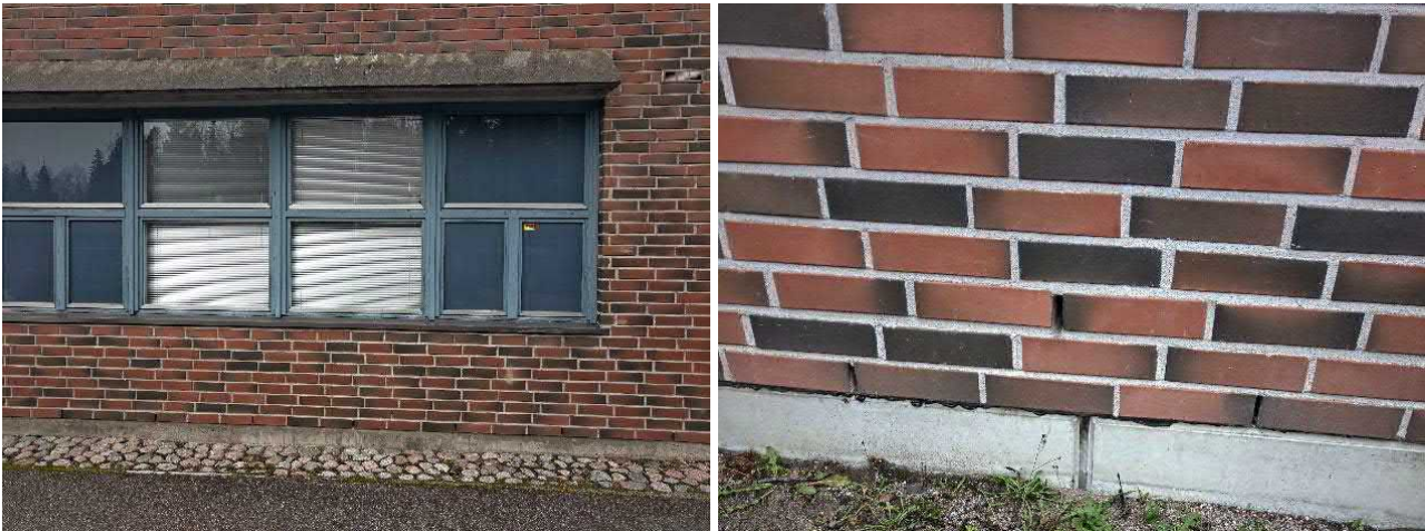
Kuva 43. Ulkoseinärakenteet on tuuletettu tiilisaumojen kautta. Vanhalla osalla (vasen kuva) tuuletuksen toteutuksesta ei ole täyttä varmuutta, koska rakennekuvien perusteella rakenteessa ei ole erillistä tuuletusrakoa.
