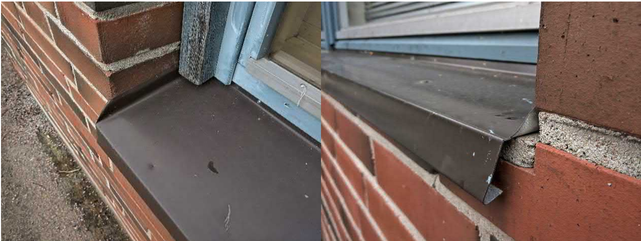
Kuva 48. Ikkunalistoissa (oikea kuva) havaittiin maalivaurioita. Ulkoseinärakenne ei pääse tuulettumaan vesipellin alta ja vesipellit on asennettu lähes vaakatasoon (vasen kuva).
