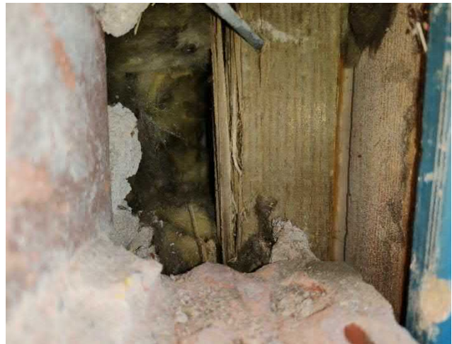
Kuva 54. Rakenneavauksessa I9 pystykarmirakenteissa havaittiin vesijälkiä.
