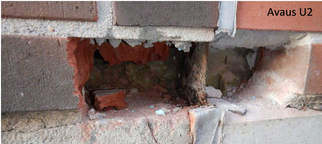
Kuva 47. SRK-tilojen ja vanhan osan liikuntasamaan kohdalle tehdyn avauksen U2 kautta havaittiin, että vanhan ulkoseinän bitumikaista jatkuu vanhan ulkoseinälinjan mukaisesti.
