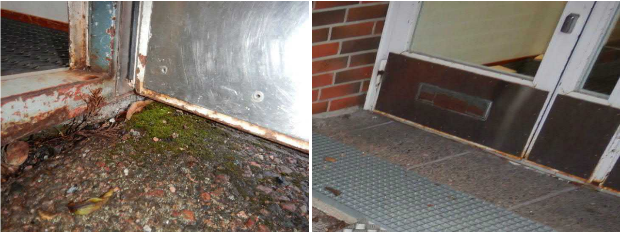
Kuva 50. Rakennuksen vanhan osan ulko-ovissa havaittiin toistuvaa korroosiovauriota ovien alareunassa (vasemmassa kuvassa ovi 6 ja oikeassa ovi 1 (ks. Kuva 2)).
