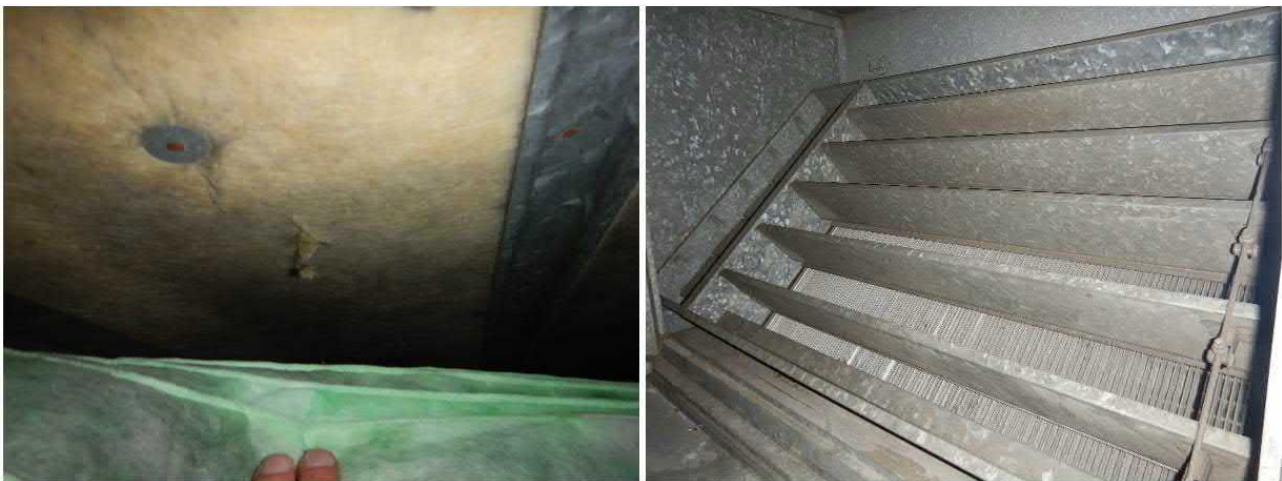
Kuva 109 Suodattimen jälkeisen osan äänenvaimenninmateriaaleissa pieniä pintavaurioita. Koneen LTO-osan pinnat puhtaat. LTO:n ohituspeltien toimintaa ei tutkimuksissa todennettu.
