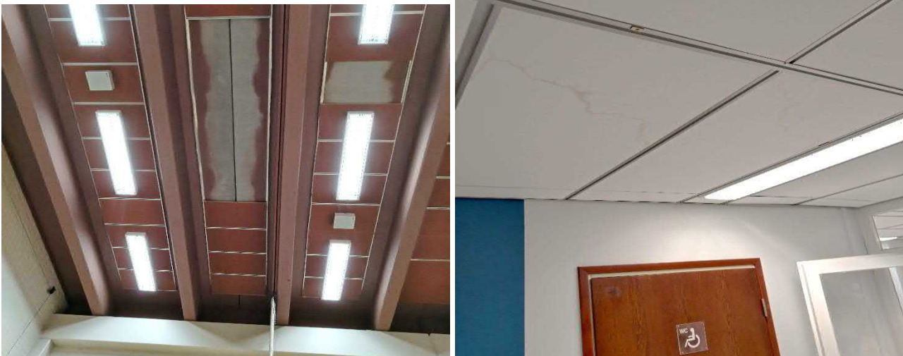
Kuva 96 Käytävän katossa värjäytyneitä kattolevyjä. Liikuntasalin katosta puuttuu äänieristelevyjä.
