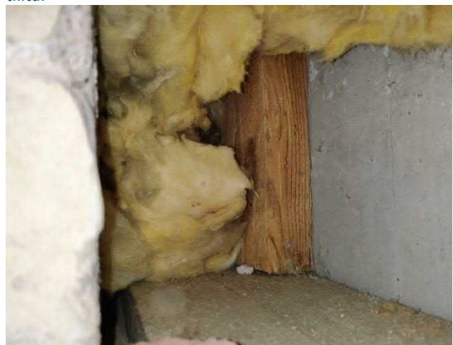
Kuva 58. Rakenneavauksessa I9 ikkunan yläkulmaan havaittiin apukarmin päällä apupuua. Karmin päällä on lieviä kosteusjälkiä.
