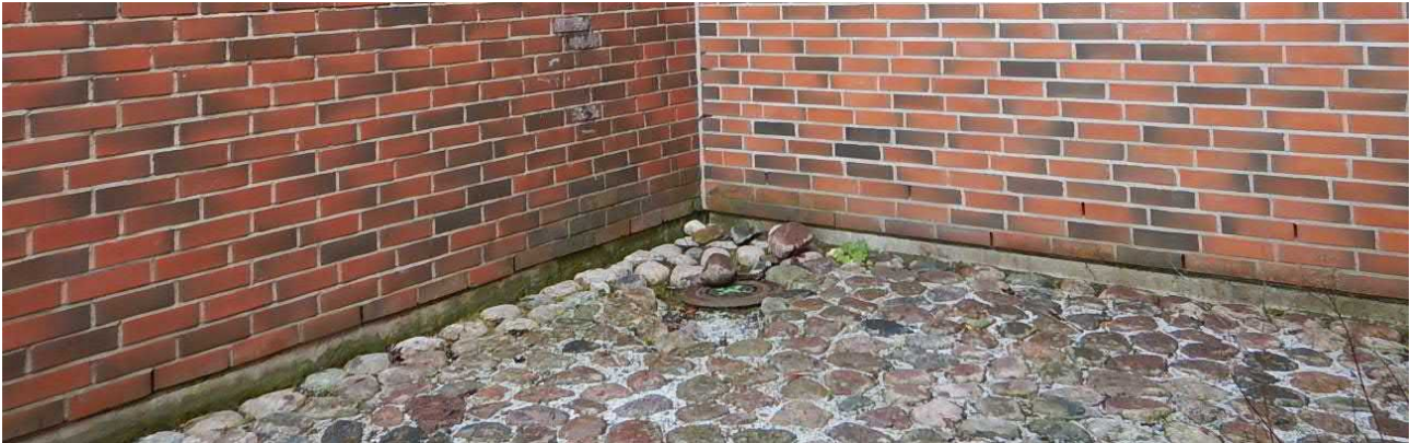
Kuva 45. Julkisivujen sisänurkissa havaittiin toistuvaa leväkasvustoa sokkelin ja julkisivumuurausten pinnoilla.
