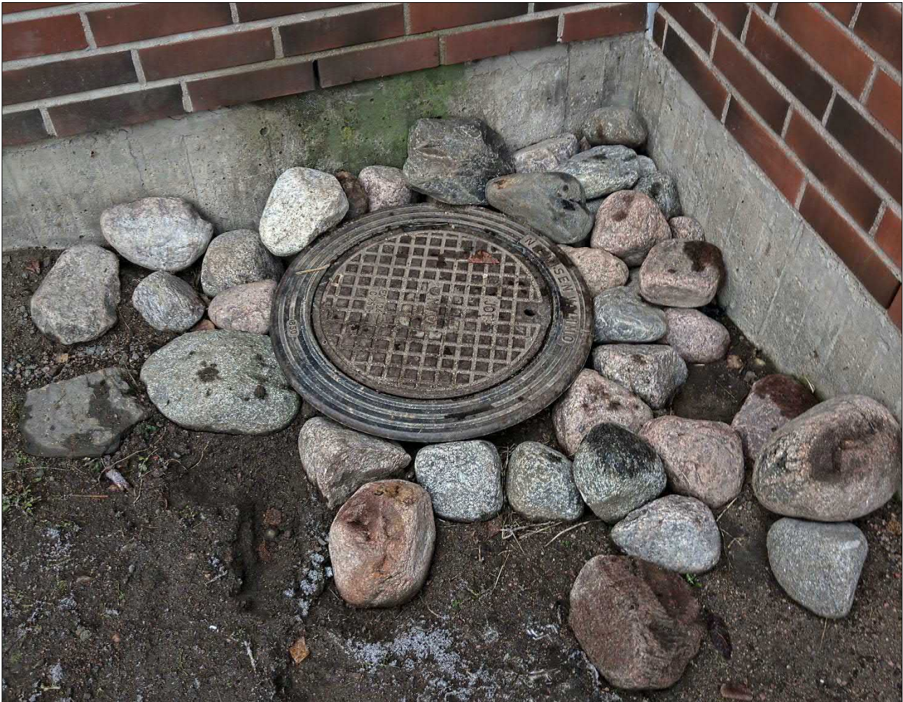
Kuva 5. Rakennuksen vierustalla havaittiin painaumia nurkka-alueilla.
