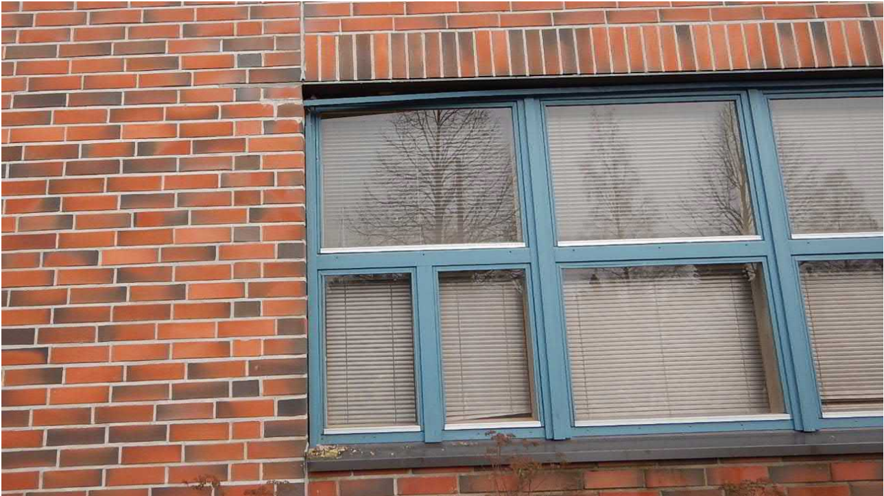
Kuva 49. Ikkunalista on irronnut ja eristetilasta on tippunut mineraalivillaa.
