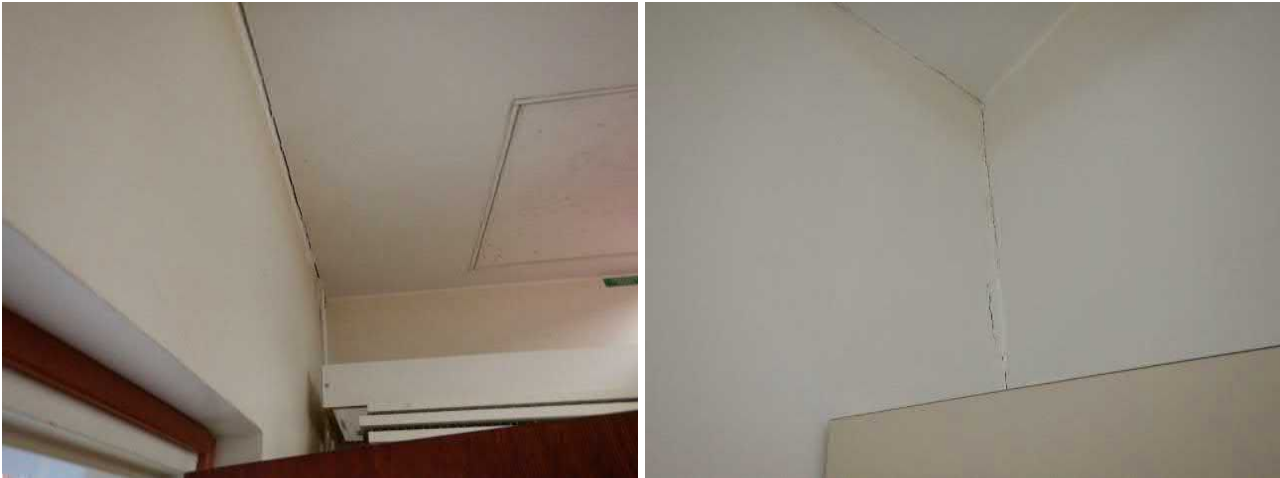
Kuva 95. Rakennuksen B-osan liitoskohdissa havaittujen lattiapinnan halkeamat jatkuivat väliseiniin ja sisäkaton rajaan.
