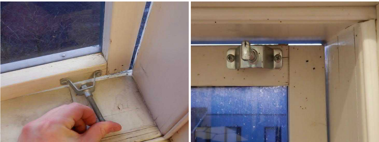
Kuva 51. Alakoulun 2. kerroksen luokkatilassa 206 havaittu puute uloimman ikkunan tiiveydessä. Karmin päällä oli vesijälkiä.
