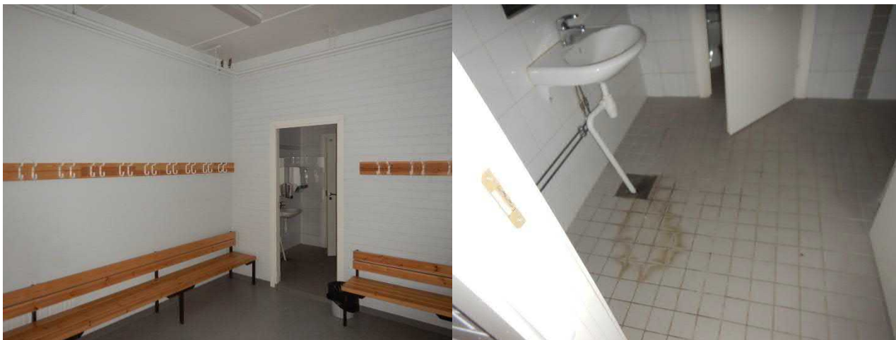
Kuva 91 Pukuhuoneiden lattiapinnat ovat kohtalaisessa kunnossa. Märkätilojen laattojen saumaukset kuluneet ja kaadot heikot.
