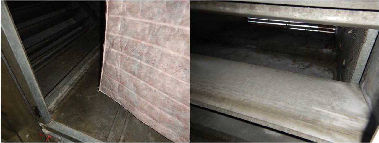
Kuva 124 Suodattimen jälkeiset osat ja lto:n pinnat kohtuullisen puhtaita. Ulkoilmakanavan pohjalla kouru, johon kanavaan päätyvän veden tulisi kerääntyä. Koneen toisella puolella mahdollisesti poistoputki.
