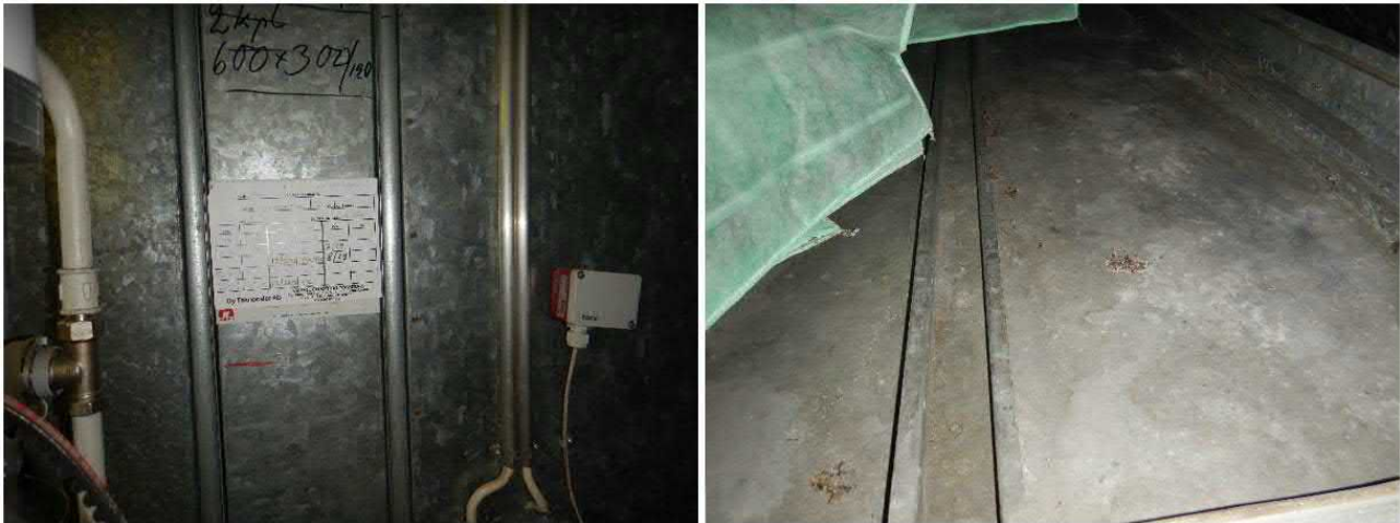
Kuva 108 Huoltotarran mukaan suodattimien huoltoväli on ollut riittävän tiheä, suodatin osan jälkeisessä osassa havaittiin karkeaa likaa ja selviä kosteusjälkiä.
