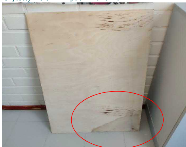
Kuva 70. Sokean ikkunan avauksessa I7 sisäverhouslevyssä oli kosteusvauriojälkiä.
