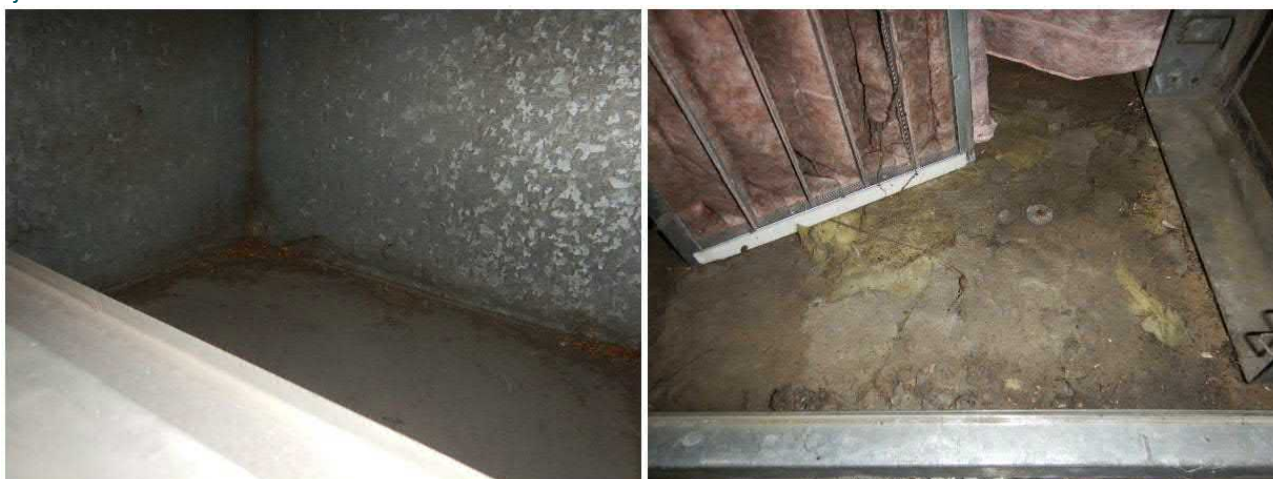
Kuva 118 Keittiön IV-koneen ulkoilmakammiossa jonkin verran likaa. Kammiossa ei vesitystä. Koneen suodattimen jälkeiset rikkoutuneet mineraalivilla pintaiset osat toimivat kuitulähteinä keittiön sisäilmaan. Suodattimen jälkeisessä osassa ja lämmönsiirrinten pinnoilla likaa.
