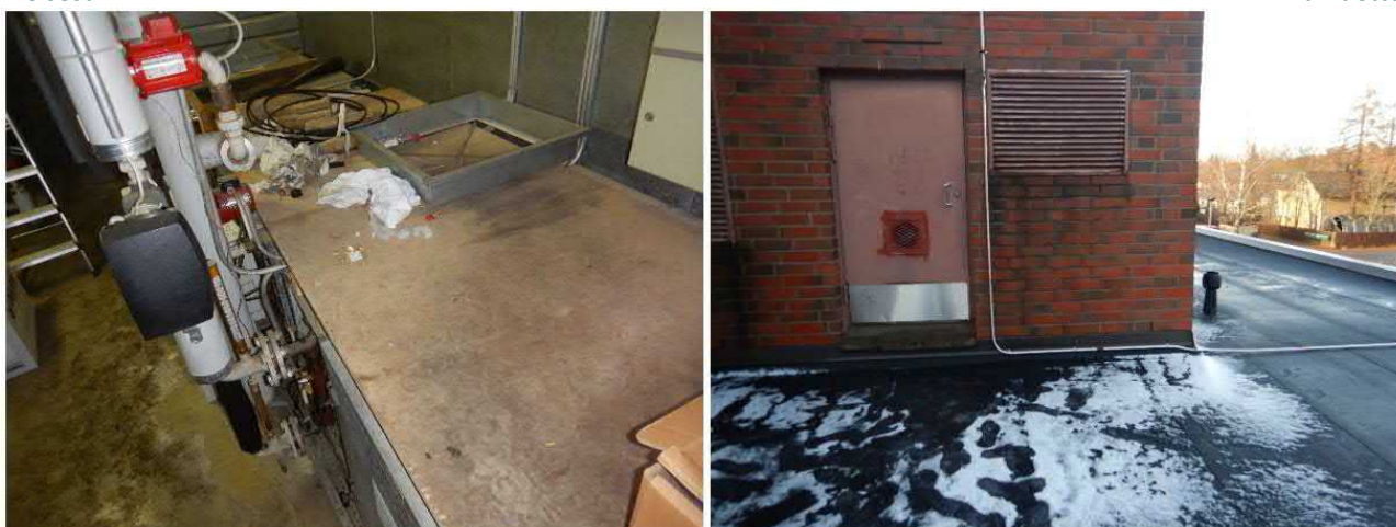
Kuva 117 IV-konehuone vaatisi siivousta. Keittiön koneen ulkoilmasäleikön alapuolella myös selviä jälkiä seinärakenteen ajoittaisesta kastumisesta.
