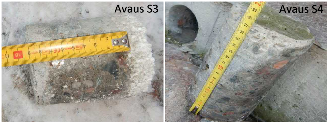
Kuva 23. Liikuntasalin sokkelin (Vas.) Ulomman betonikerroksen paksuus liki puolet vähemmän kuin muulla vanhan koulun osalla (Oik.).
