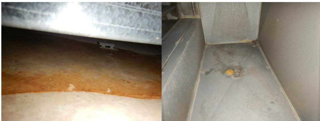
Kuva 132 Koneen alapuolella kuivuneita vesijälkiä. Koneen ulkoilmakammio vesitetty ja lähes puhdas.
