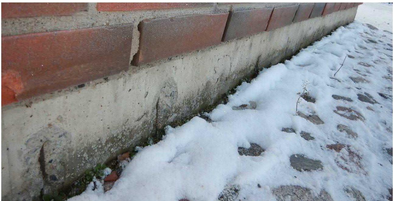
Kuva 24. Liikuntasalin sokkelissa raudat ovat asennettu liian lähelle sokkelin ulkopintaa ja rapautumisen johdosta on ohut betonipeitekerros lohjennut.
