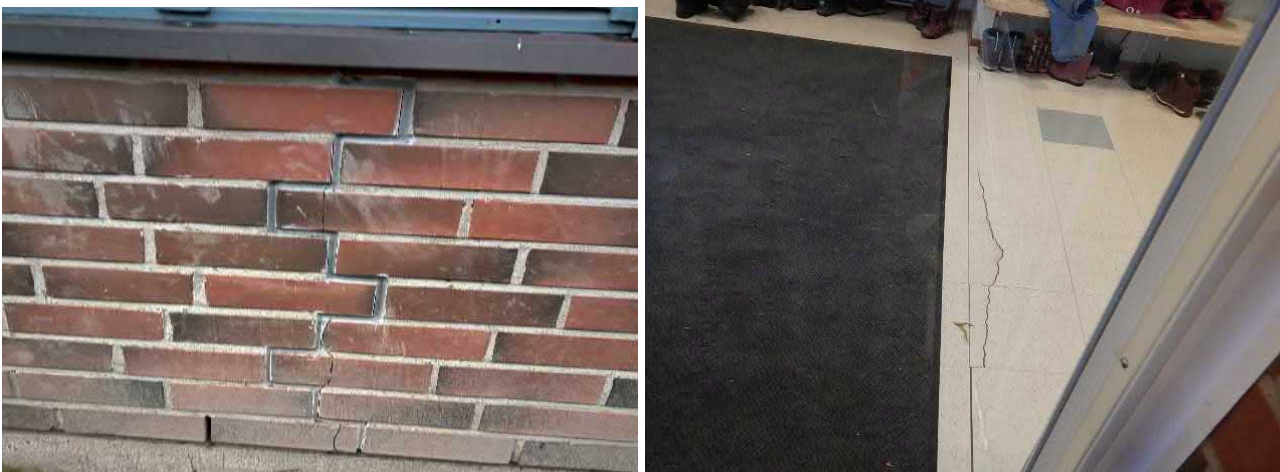
Kuva 36. Vanhan osan julkisivumuurauksessa (vasen kuva) havaittiin useita rakenteellisia halkeamia. Vanhan osan ja alakoulun laajennusosan (oikea kuva) kohdalla lattiassa havaittiin halkeama.
