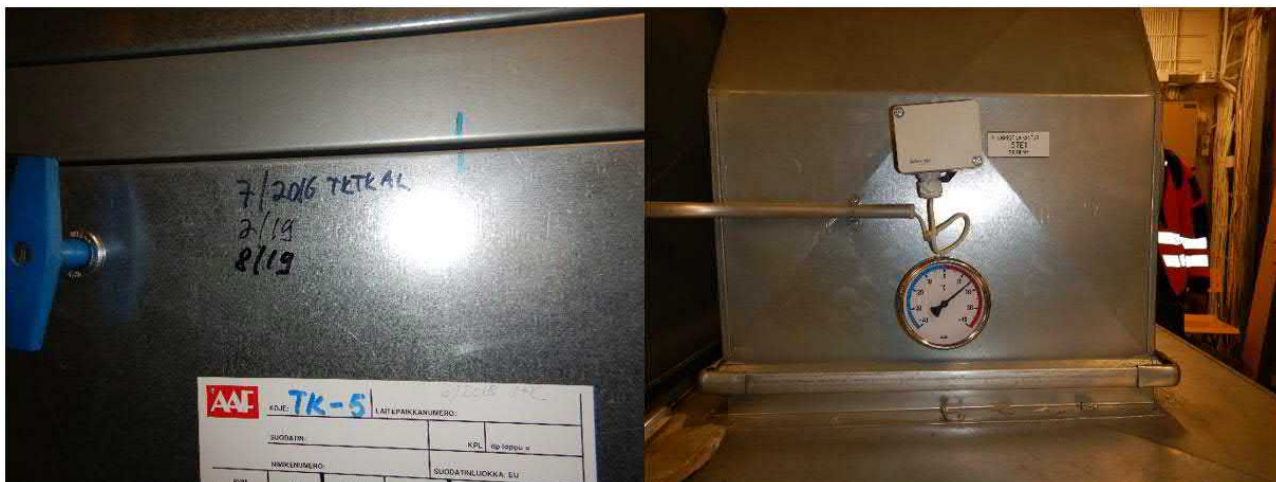
Kuva 131 Huoltotarran täyttymisen jälkeen tehtyjen huoltotöiden ajankohtia on merkattu koneen huoltoluukkuun. Tuloilman lämpötila-anturin (STE1) vieressä oleva lämpötilamittari näytti tuloilman lämpötilaksi vain + 15 °C.
