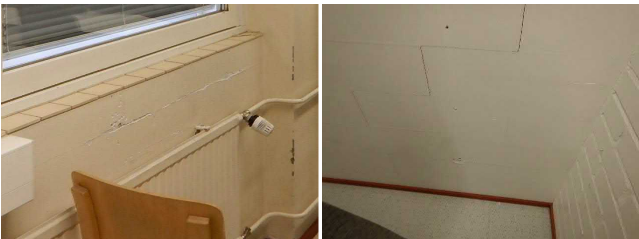
Kuva 98. Vanhan osan ikkunan alapuolisilla osilla havaittavissa halkeilua tiilimuurauksen saumojen kohdalla (Vas.). Laajennus osalla halkeilua havaittiin ikkunoiden alapuolisen osan lisäksi ulkoseinissä (Oik.).
