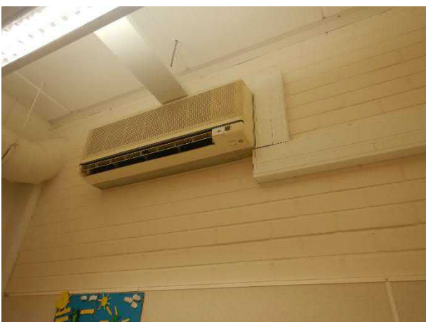
Kuva 103 Luokkatilassa 206 myös kaksi tilakohtaista jäähdytyslaitetta, joiden suodattimien ja jäähdytinpintojen puhtaus on tarkistettava säännöllisesti.
