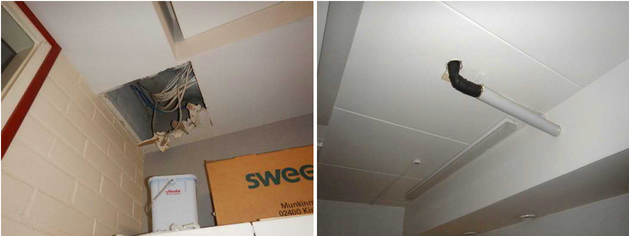
Kuva 97 Sisäkaton läpiviennit osittain puutteellisia.
