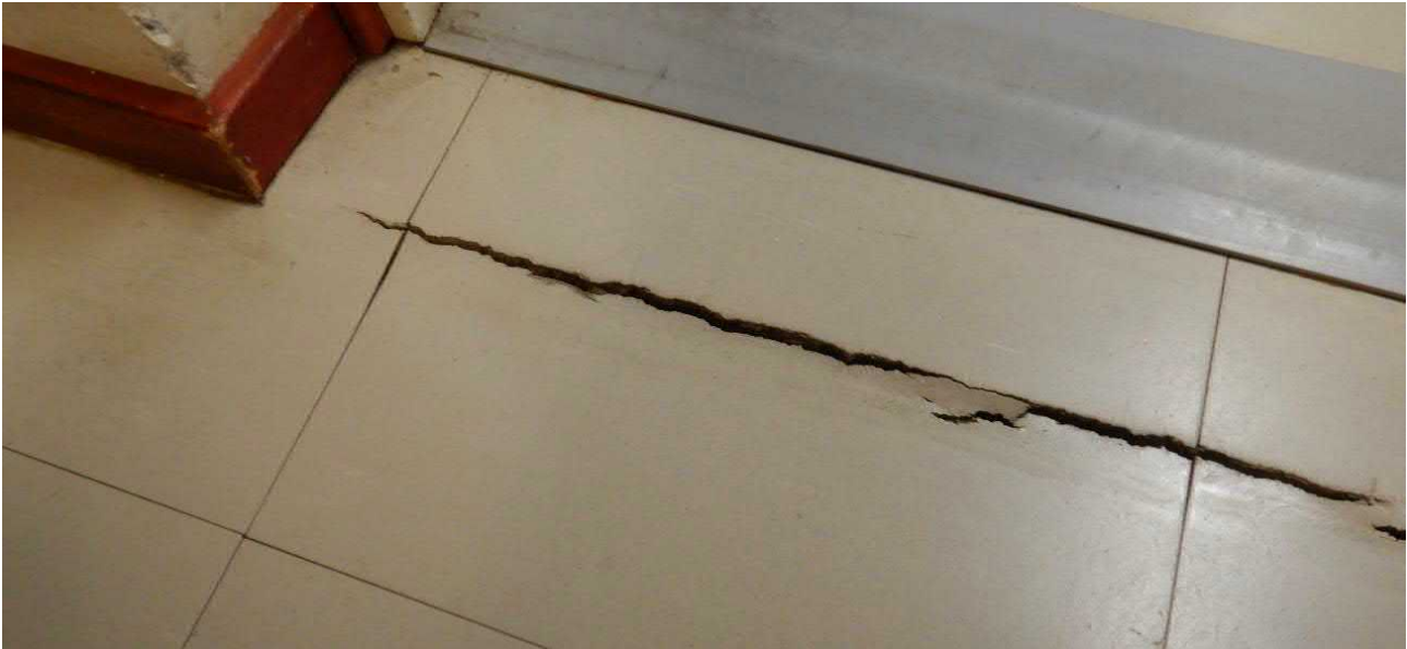
Kuva 93. Rakennuksen B-osassa havaittuja lattian halkeamia.
