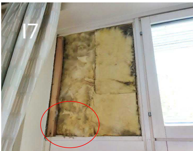
Kuva 69. Sokean ikkunan avauksessa I7 havaittiin kosteusvauriojälkiä ympyrän osoittamalla alueella.
