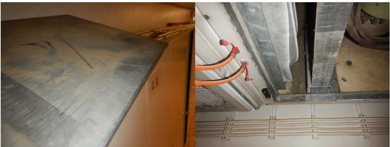
Kuva 129 Koneen ilmasuodattimen jälkeiset pinnat selvästi likaantuneita.
