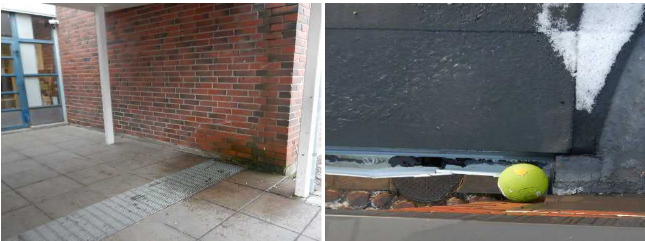
Kuva 73. Kuvat sisäpihan katoksen alapuolelta sekä päältä. Katoksen vedenohjauksesta johtuen sadevedet valuvat sadevesikourun ohitse ja tippuvat betonilaattojen päälle. (kuvassa näkyvä pallo ei vaikuta vedenohjaukseen).
