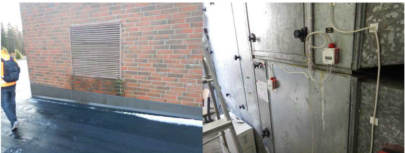
Kuva 123 Ulkoilmasäleikön alapuolinen seinärakenne kastuu ajoittain, myös koneen sisäpuolisissa osissa merkkejä veden ja lumen päätyemisestä suodattimiin.
