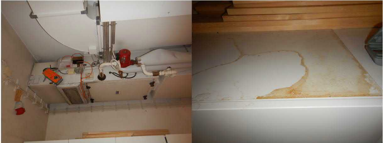
Kuva 128 puutyötilan koneen kiertoilmatoiminto mahdollisesti poistettu. Koneen alapuolisen kaapiston päällä kuivuneita vesijälkiä.
