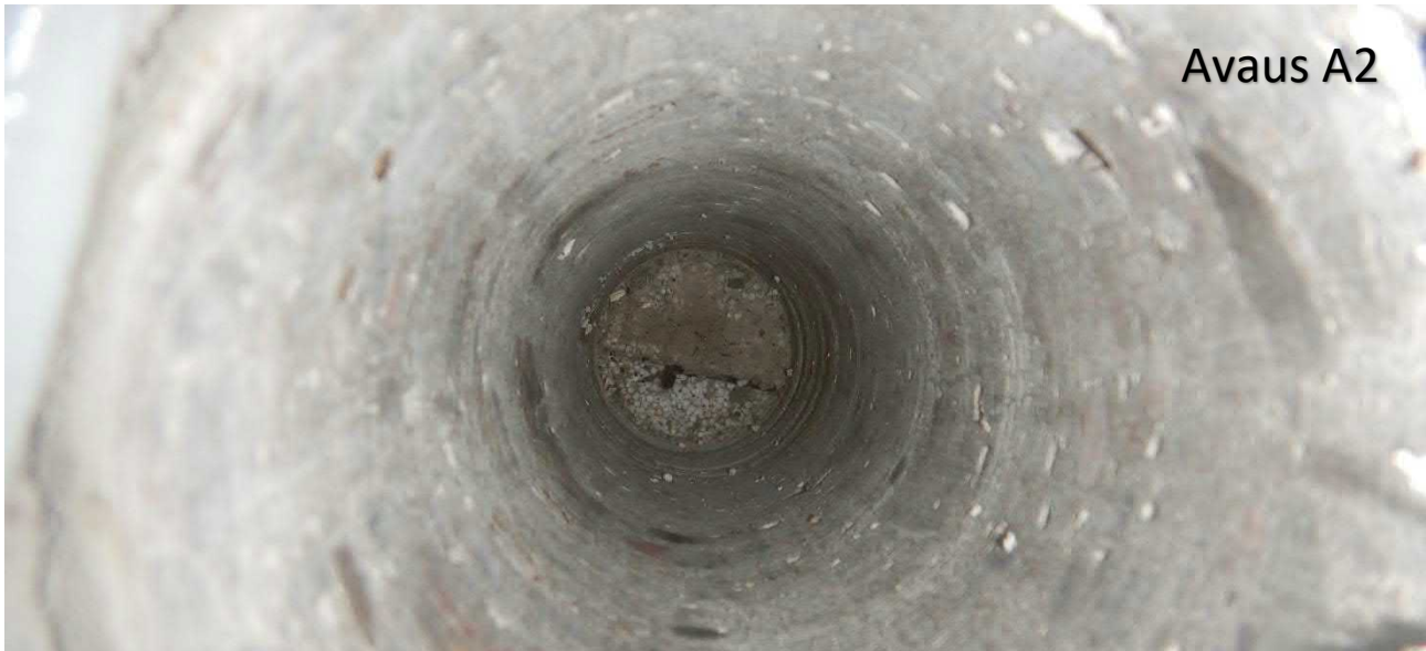
Kuva 29. Vahvistetun paalulinjan lähelle tehdyn avauksen (A2) kohdalla betonin paksuus 400 mm.
