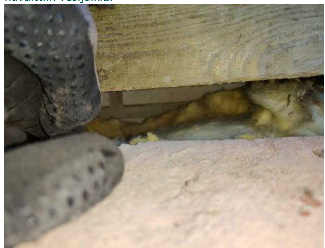
Kuva 56. Rakenneavauksen I9 ikkunan alapuolelle tehdyssä avauksessa havaittiin, että sisäkuori muurattua tiiltä.
