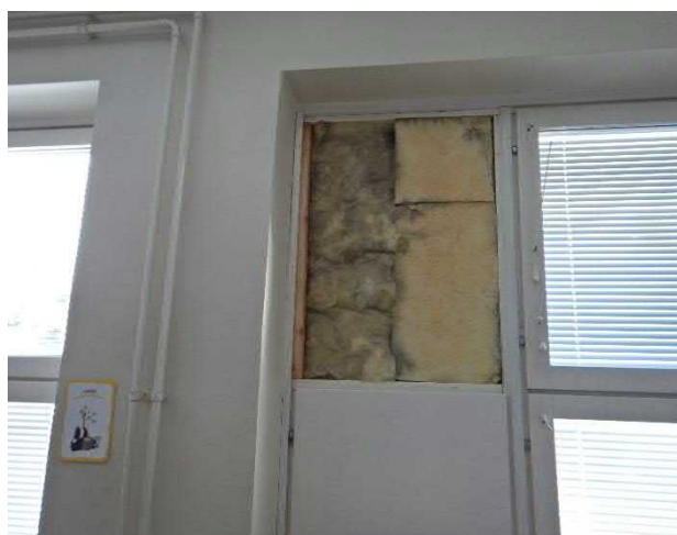
Kuva 68. Rakenneavauksen I6 ikkunan sisäpuolinen avaus. Rakenteessa ei todettu höyrynsulkua. Karmien välit on lämmöneristetty mineraalivillalla ja rakenne on levytetty molemmin puolin vanerilla.
