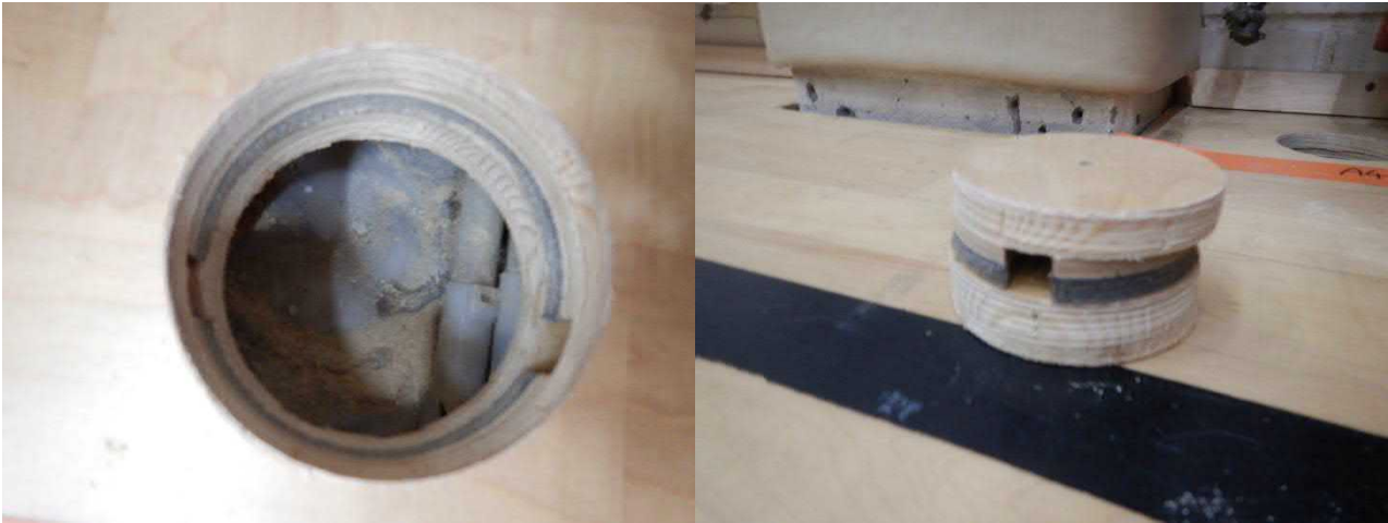
Kuva 89 Liikuntasalin lattiassa useampi parkettikerros päällekkäin.
